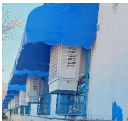
Figura 1: Climatizador instalado na escola
