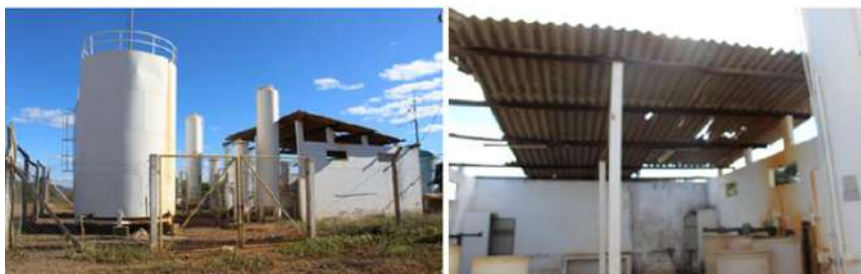
FIGURA 2 – ESTAÇÃO DE TRATAMENTO DE ÁGUA EM SITUAÇÃO DE ABANDONO – AGROVILA 2
