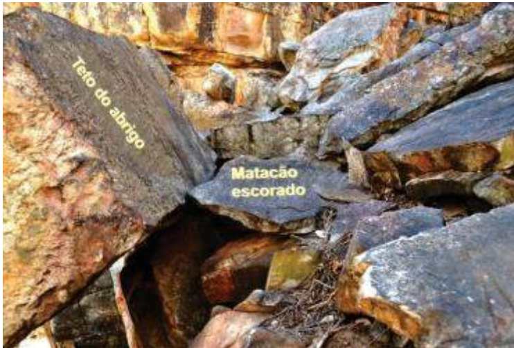
Figura 267 – Matação escorado no teto do abrigo
