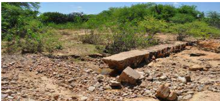
Figura 306 – Erosão causada pela desastrosa interferência
