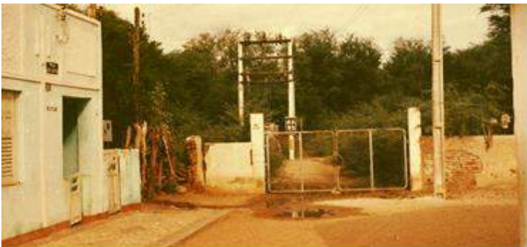
Figura 177 – Subestação da COELBA, no final da Rua do Garguelo
