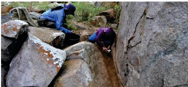
Figura 190 - Sondagem junto ao suporte
