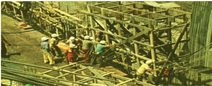
Figura 77 – Perigos na construção da barragem
