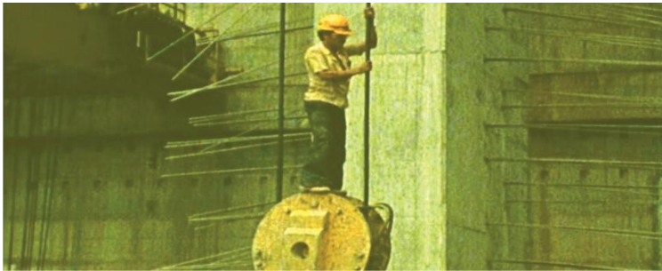
Figura 76 – Perigos na construção da barragem
