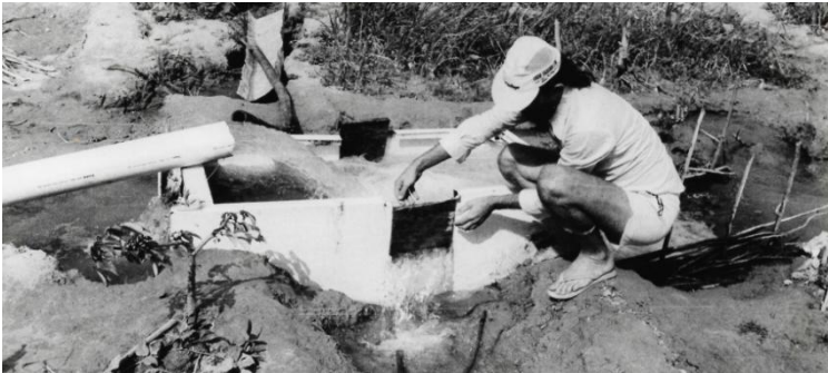
Figura 87 – Sistema artesanal de distribuição de água
