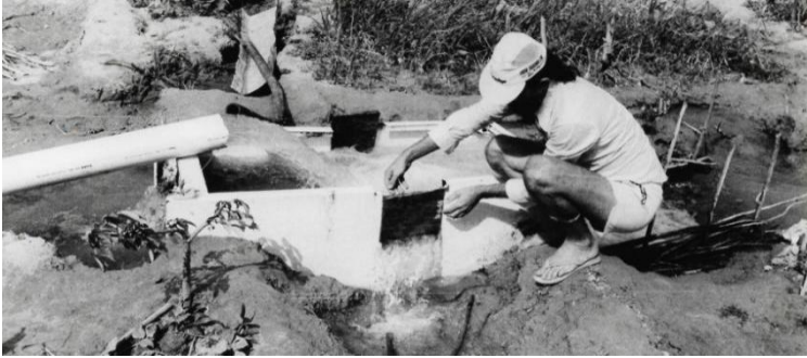
Figura 201 – Sistema artesanal de distribuição de água
