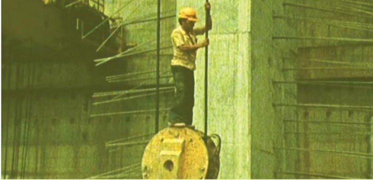
Figura 193 – Perigos na construção da barragem
