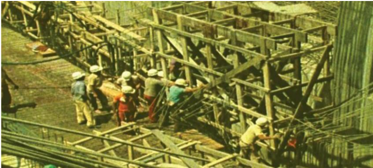
Figura 194 – Perigos na construção da barragem
