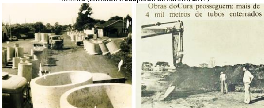
Figura 7 – Anilhas prontas para serem enterradas na Rua Guarapuava, próximo ao Portal de Dourados. Ex-prefeito José Elias (1977-1982) 38 observa obras do CURA. Fonte: Jornal O Progresso , 10/04/198, p. 1-Arquivo Pessoal de José Elias Moreira (Extraído e adaptado de Santos, 2016)
